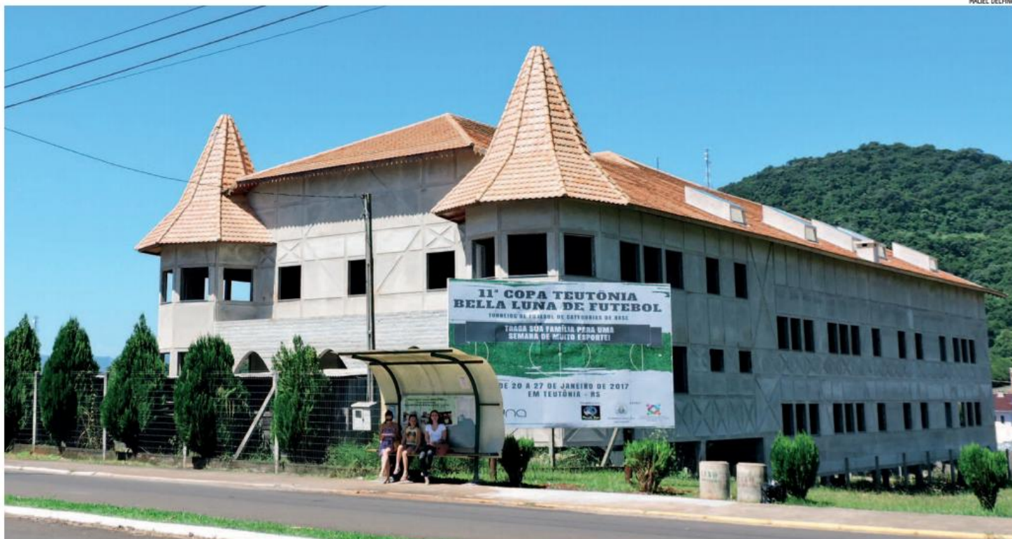
ELEFANTE BRANCO: em Teutônia, prédio em estilo enxaimel, iniciado em dezembro de 2010, custa a ser concluído. Obra de mais de seis anos já apresenta sinais de deteriorização
