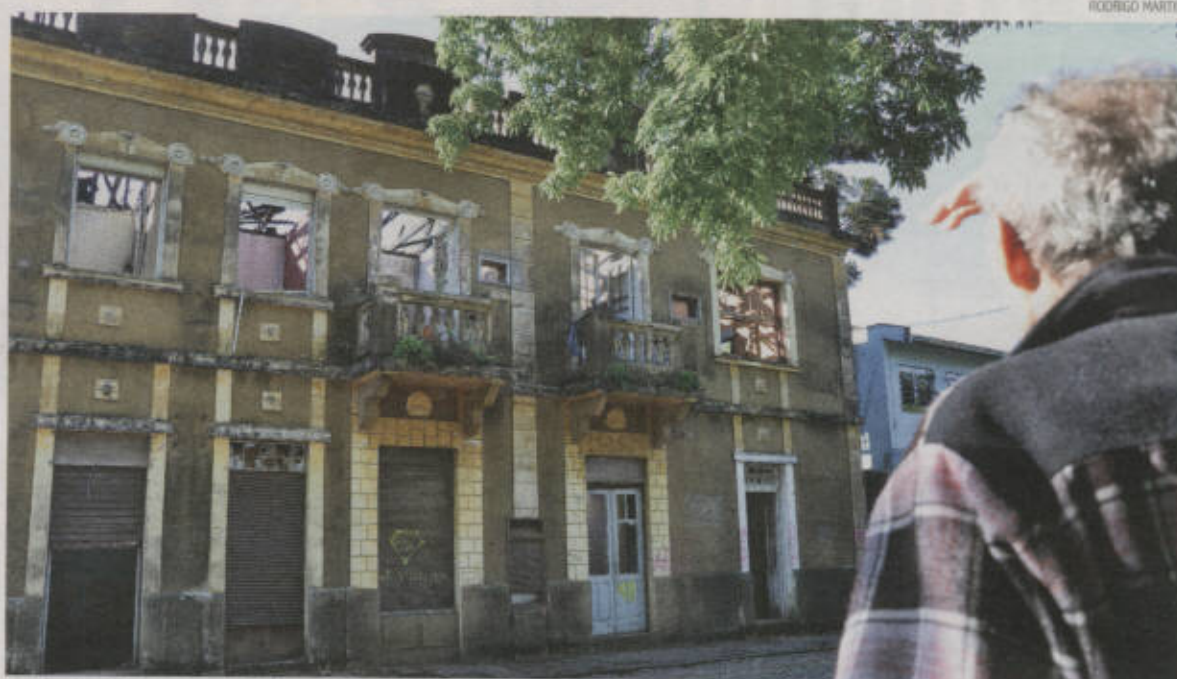
Mais de 50% da estrutura do prédio catalogado no inventário cultural de Lajeado está comprometida após o incêndio
