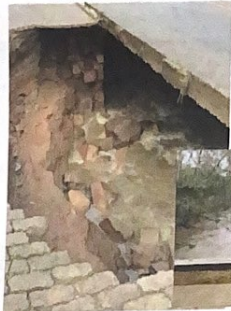
Em Lajeado, pavimentação cedeu em consequência das chuvas
