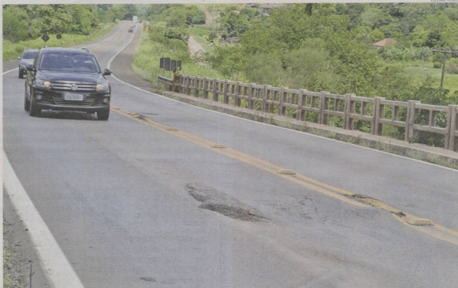
PERIGO AUMENTA: o trecho de pista simples da BR-386 fica ainda mais perigoso com os buracos e desníveis. Placas de sinalização estão obstruídas
