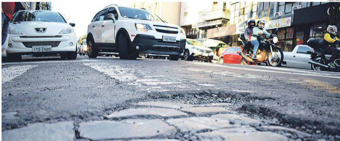
Trecho que receberá o capeamento asfáltico apresenta péssimas condições. Obra inicia amanhã com o trabalho de frenagem do asfalto ruim
