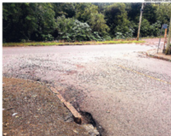
PERIGO: falta de visibilidade da faixa de segurança
