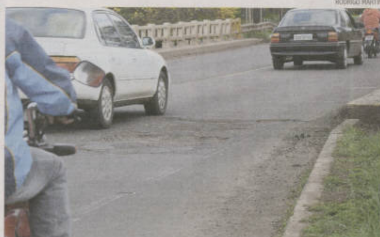
Veículos invadem a pista contrária para escapar dos buracos na rodovia
