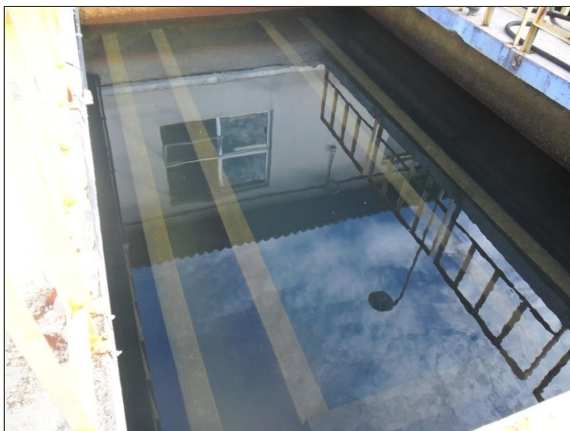
Figura 45: Filtração da ETA Nova.
