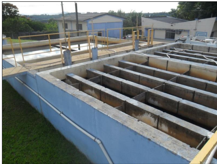
Figura 38: Sistema de Floculação Hidráulica e Decantação.
