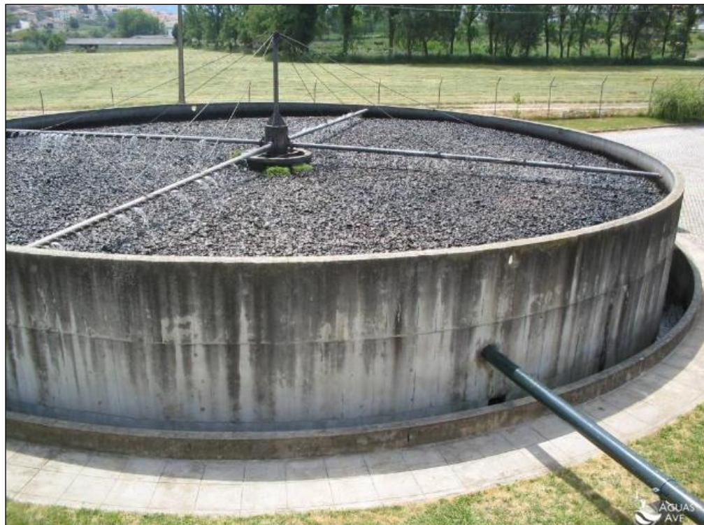
Figura 85: Dispersão do Efluente de forma adequada em Filtro Biológico.
