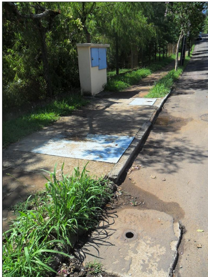
Figura 75: Elevatória da Av. Sete de Setembro.
