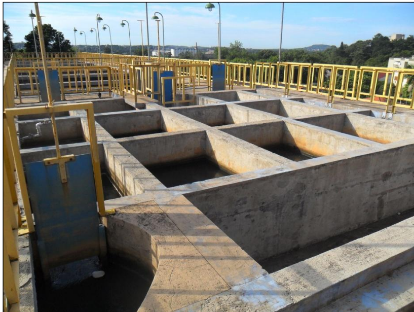
Figura 42: Sistema de Floculação Hidráulico.
