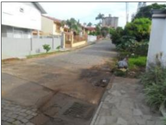
Figura 157: Bocas de Lobo Obstruídas.
