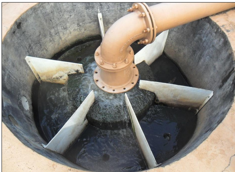
Figura 82: Entrada do Efluente no Reator Anaeróbico.
