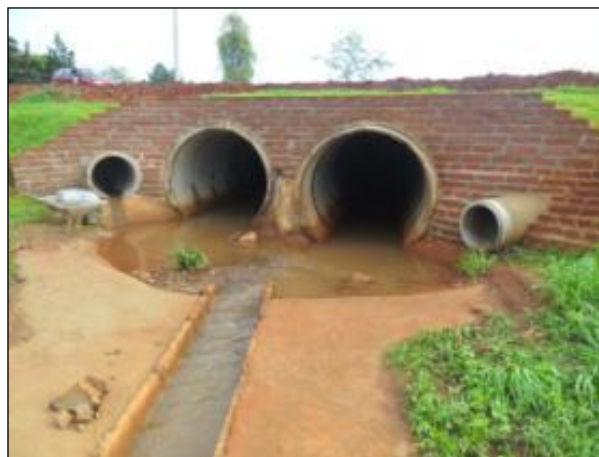
Figura 142: Chegada das Tubulações Afluentes.
