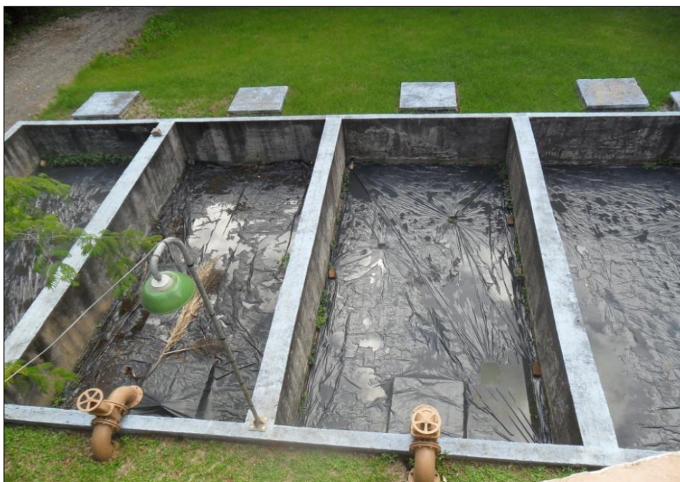
Figura 87: Leitos de Secagem.
