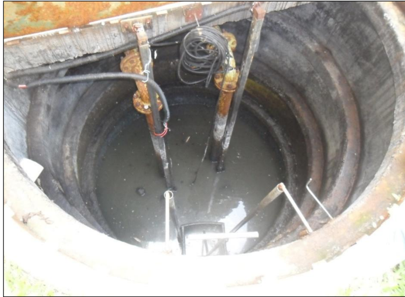
Figura 79: Chegada de esgoto.
