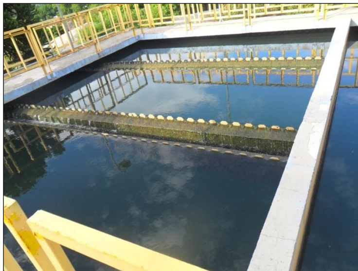
Figura 44: Saída da Água do Decantador.
