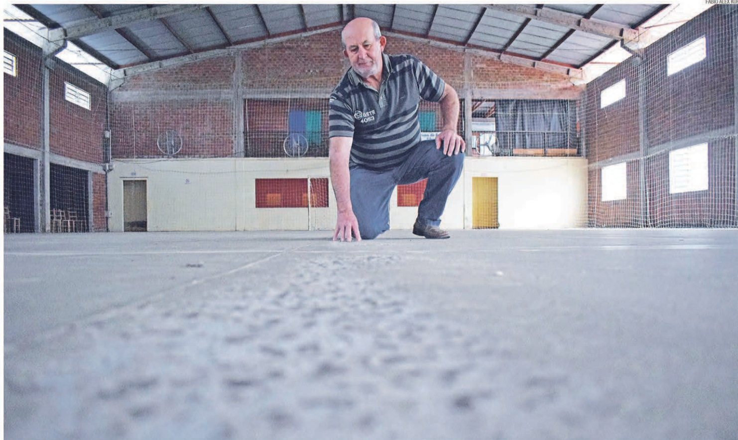
Leopoldo Gerhardt mostra desgaste no piso e na marcação da quadra esportiva. Conforme ele, nunca foi feita outra pintura no local desde a fundação do ginásio
