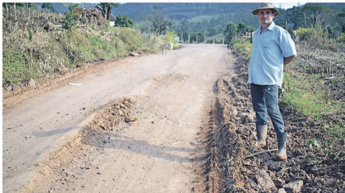
Rambo mostra ponto onde ônibus atolou na semana passada. Ele é um dos moradores que cobra melhorias na estrada e limpeza das valetas
