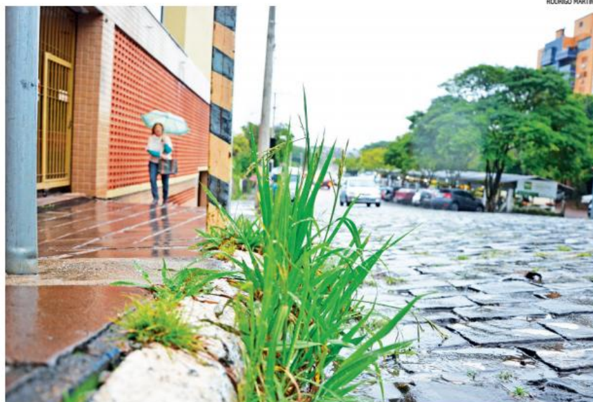
Na rua Santos Filho, ao lado da câmara de vereadores, inço avança sobre a calçada. Valor do contrato surpreendeu
