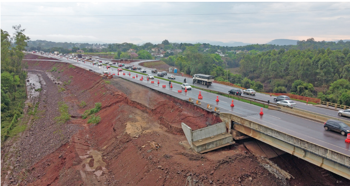
Enchente danificou entrada na ponte sobre o Arroio Boa Vista no sentido Lajeado a Estrela
