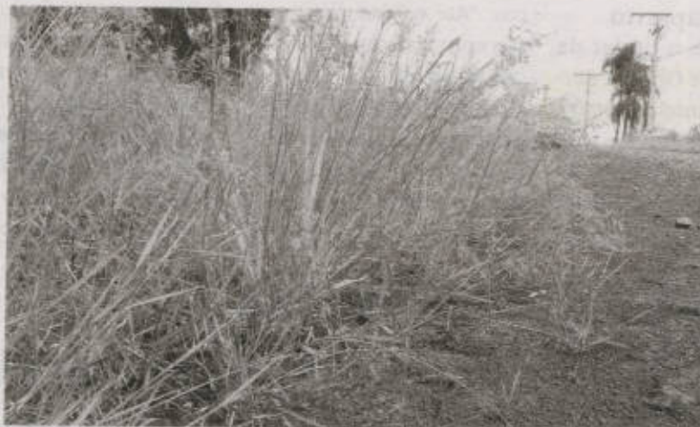
Falta de roçada faz com que a vegetação invada a Rua Selma Weissheimer
