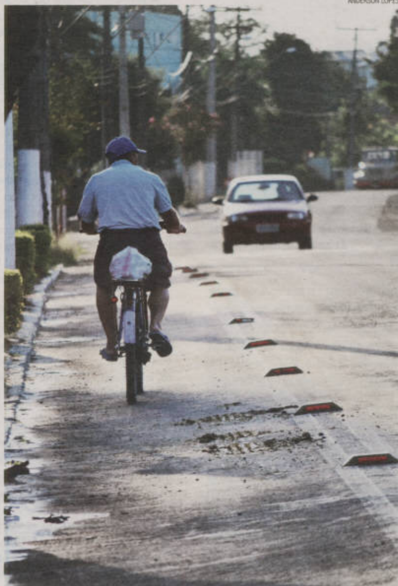
Na Rua Carlos Spohr Filho, ciclistas trafegam em ciclofaixas deterioradas
