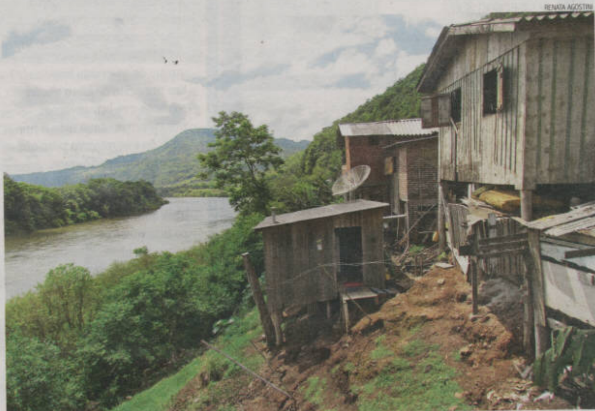
PERIGO CONSTANTE: em Roca Sales, neste ano, cinco casas de madeira foram construídas em área imprópria
