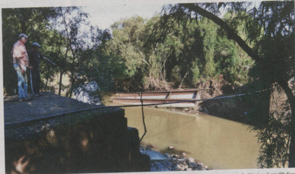
Reconstrução de ponte está estimada em R$ 420 mil. Projeto será entregue ao Ministério da Integração Nacional em 90 dias
