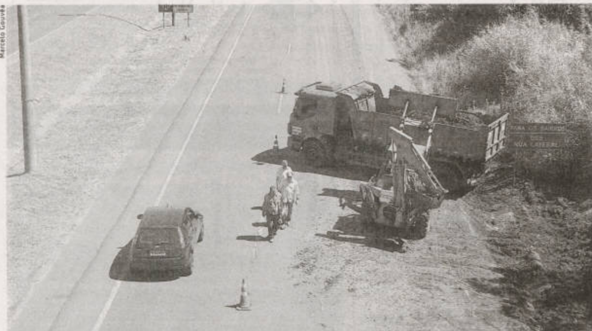
Trânsito operou em meia pista durante a limpeza. Desmoronamentos afetaram dois pontos da BR-386
