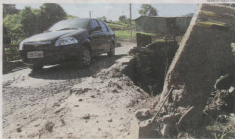
Danos na estrutura e falta de sinalização representam perigo aos motoristas
