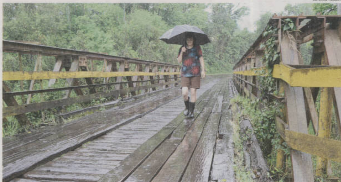
Entre os motivos está a falta de recurso municipal para construção de nova ponte sobre o Arroio Alegre
