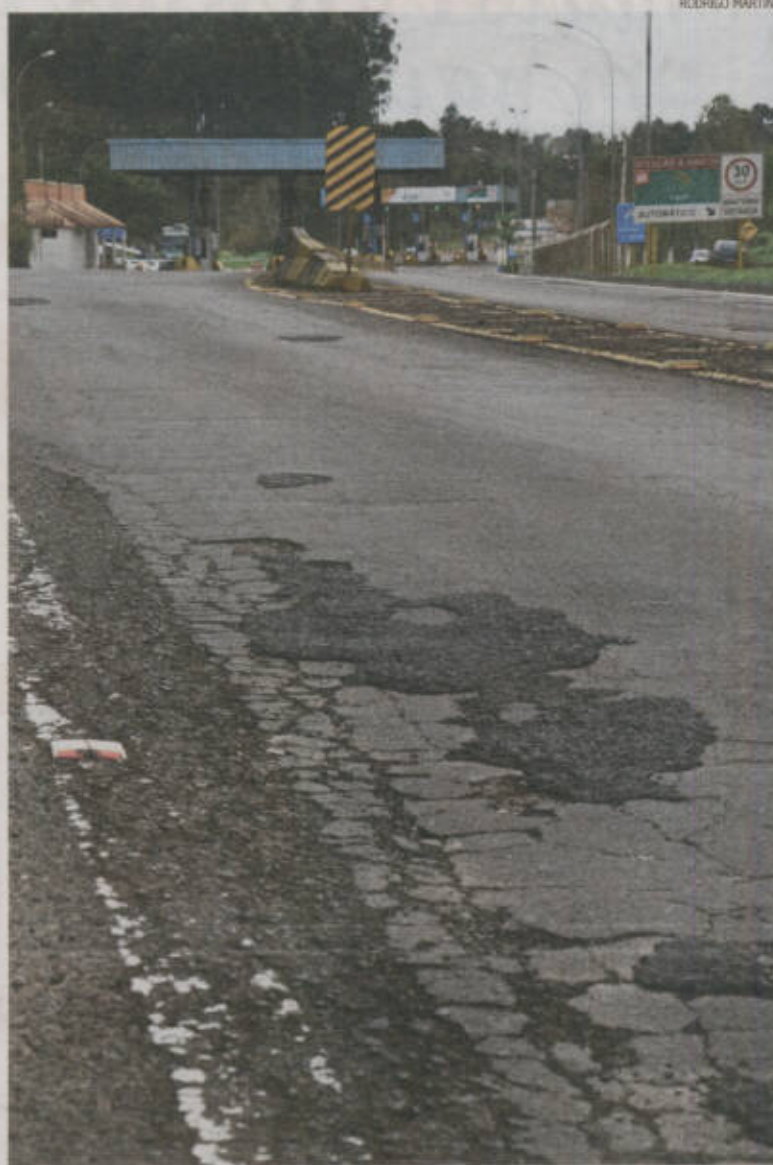
Trecho próximo à praça de pedágio de Cruzeiro do Sul apresenta problemas
