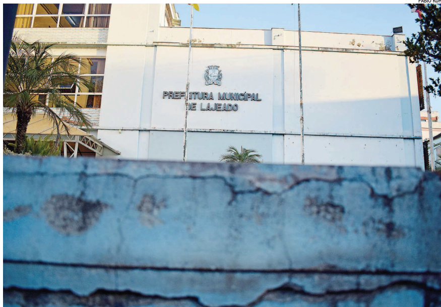
Prédio construído em 1983 apresenta problemas estruturais e passará por sua primeira grande reforma
