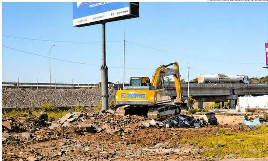
Segundo a prefeitura, objetivo é remover estruturas condenadas e comprometidas pelas enchentes, eliminando riscos à população
