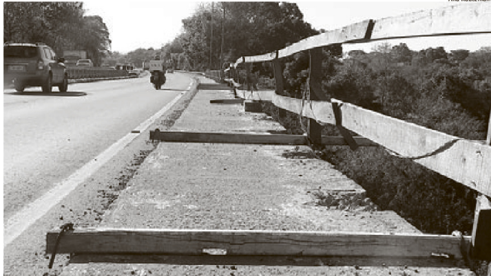
PARADA: enquanto se decide quem é responsável pela ponte, recuperação segue paralisada
