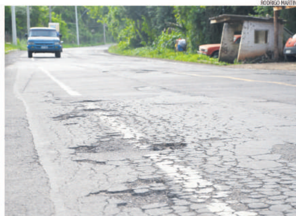
Trecho no bairro Morro 25 está entre os piores na avenida Beira Rio
