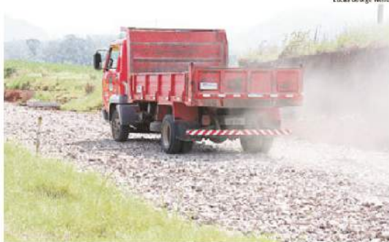
QUEIXA: moradores reclamam das irregularidades do terreno
