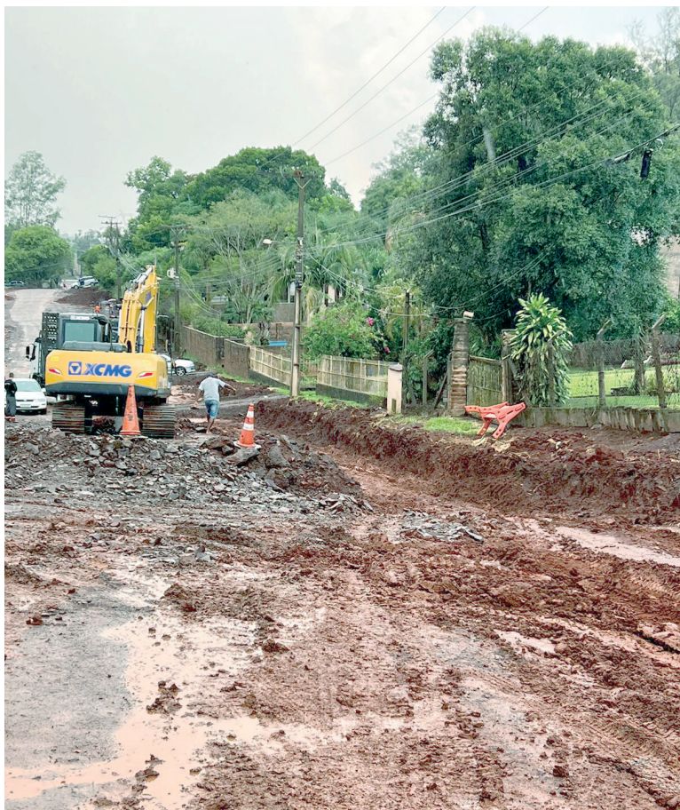
Atoleiro na rua Wilibaldo Eckert, obra iniciada em setembro passado
