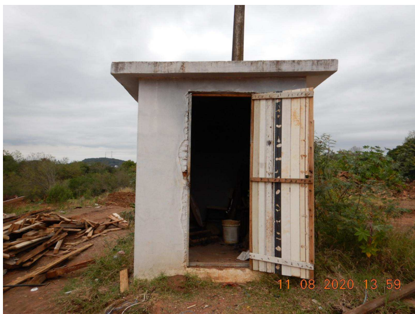
Foto 51: Construção existente, utilizada como depósito, sem sanitários;
