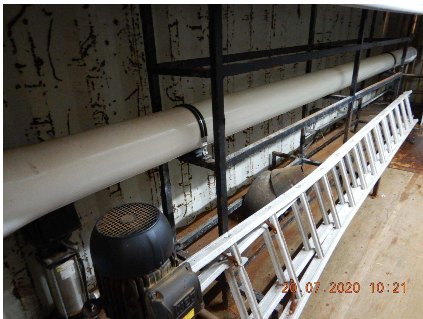
Foto 42: Sistema de osmose reversa.
