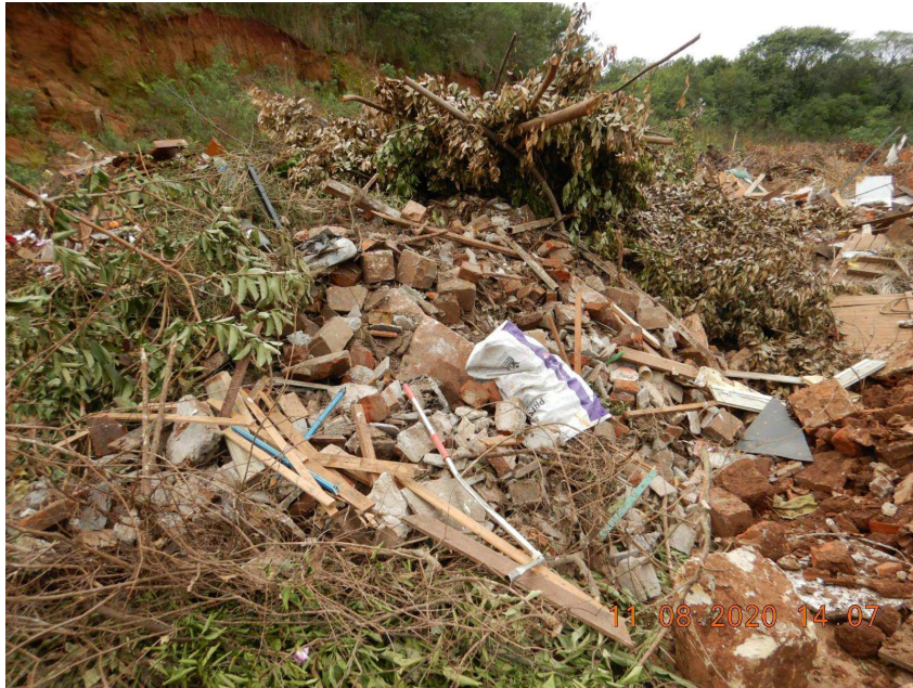
Foto 64: Resíduos de construção civil e galhos de árvores.
