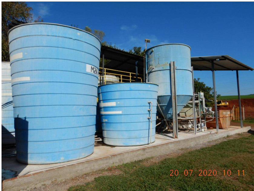
Foto 40: Planta de tratamento de efluentes instalada.
