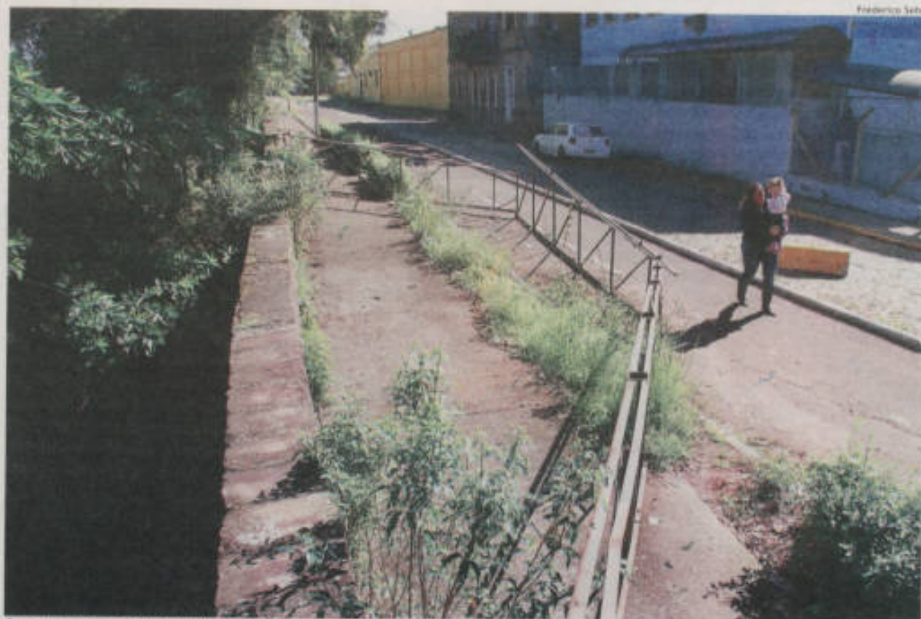
Área em frente da Escola Risque e Rabisque corre risco de desmoronar
