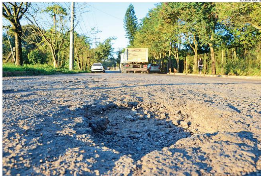
Na rua Bento Rosa, entre os bairros Hidráulica e Carneiros, motoristas precisam trafegar na contramão devido aos buracos
