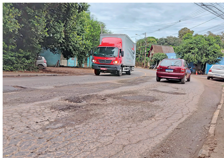
Surgimento de verdadeiras crateras no asfalto desafia motoristas
