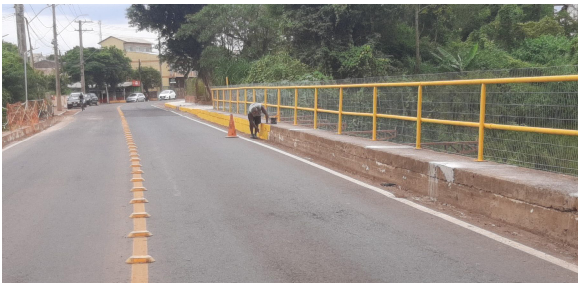
Reforma na Ponte do Saraquá está entre as obras investigadas pela CPI da câmara de Lajeado
