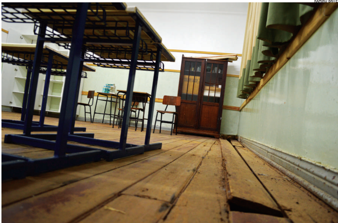
Buracos no assoalho impedem retomada segura das aulas presenciais para quatro turmas em escola estadual
