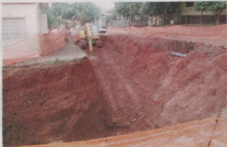
Buraco da Rua São Paulo tem nove metros de profundidade
