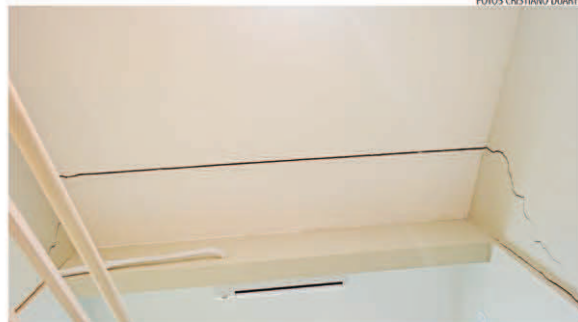
Rachadura passa de um lado a outro do prédio de ampliação da unidade
