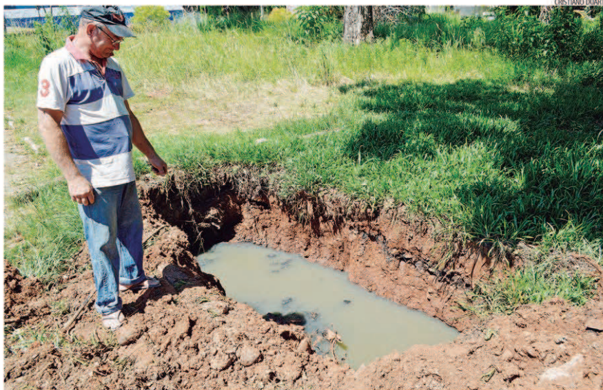
Hilário ajudou motorista a retirar carro do buraco. Há duas semanas, moradores convivem com esgoto a céu aberto
