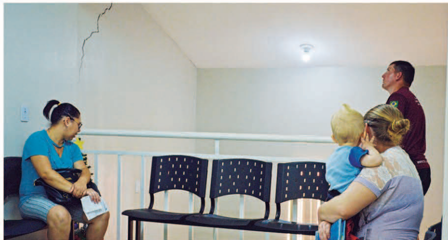
Enquanto aguardam na triagem de atendimento na UBS, pacientes demonstram preocupação com estrutura do prédio
