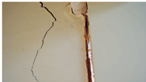
Na rachadura na parede, é possível ver o lado de fora do posto de saúde
