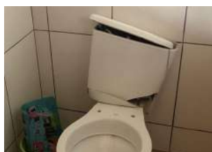
Vaso sanitário está interditado após ser depredado por usuários
