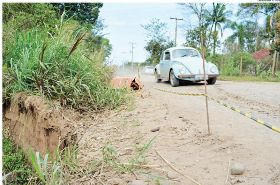
Veículos passam rente ao barranco. Moradores afirmam que erosão avança faz quase dois meses
