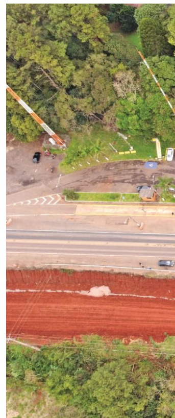
Imóvel da PRF precisa ser demolido para avanço da duplicação. Nova sede será erguida a quatro quilômetros, perto do acesso a Forquetinha
