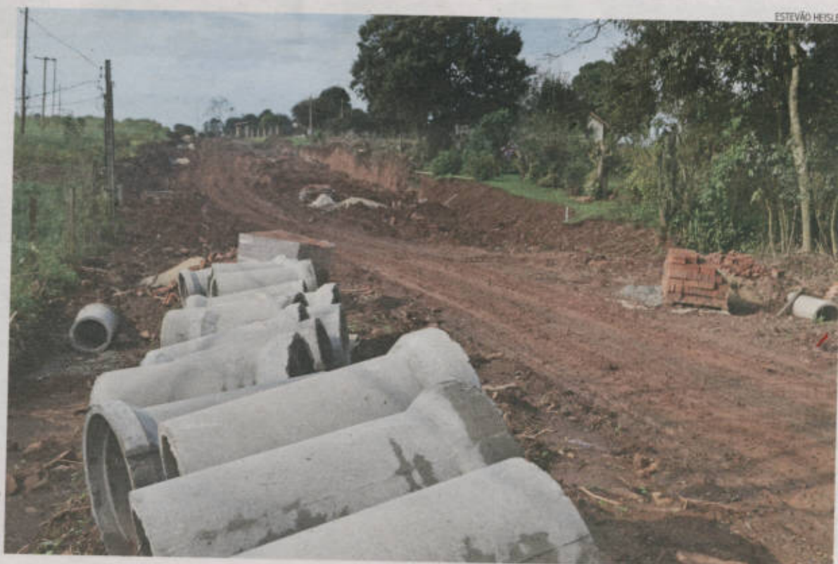
Obra iniciou em abril e, conforme contrato, deveria ser concluída em 27 de julho. Empresa deixou local há três semanas
