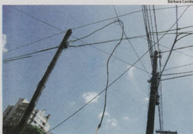
PROBLEMA: na Rua 25 de Julho, a situação se repete
