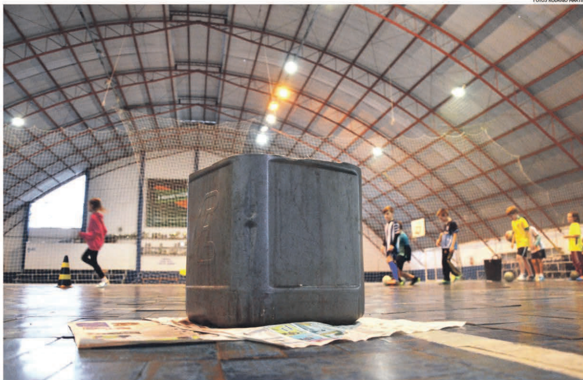
Nessa sexta-feira, alunos da escolinha do Centro Esportivo Municipal driblavam os baldes colocados para evitar que a água das goteiras se espalhasse
