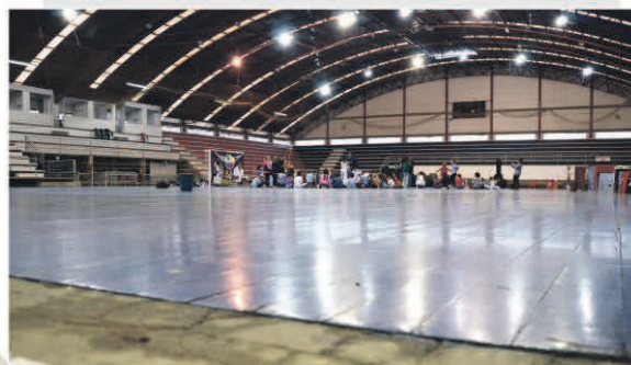
Ginásio Nelson Brancher precisa de melhorias no piso e no telhado
