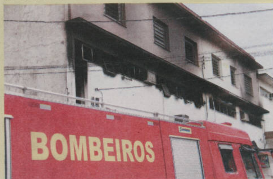
Fogo consumiu parte do prédio
