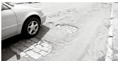
SÃO CRISTÓVÃO: na Avenida Senador Alberto Pasqualini, condutores encaram sete buracos em pouco mais de dez metros
