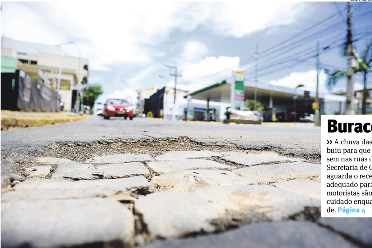
ESTRAGOS: em um trecho da Avenida Senador Alberto Pasqualini, em pouco mais de dez metros, são sete buracos
