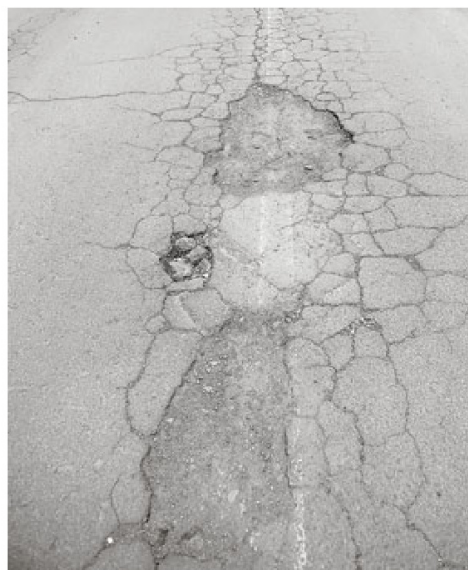
UNIVERSITÁRIO: fissuras e rachaduras na Avenida Senador Alberto Pasqualini
