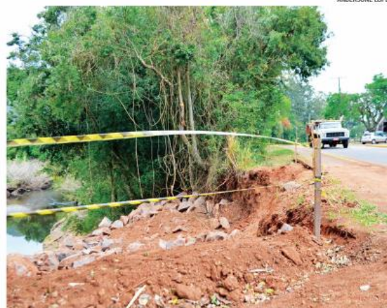
Em Teutônia, Arroio Boa Vista avança sobre a rua Daltro Filho
