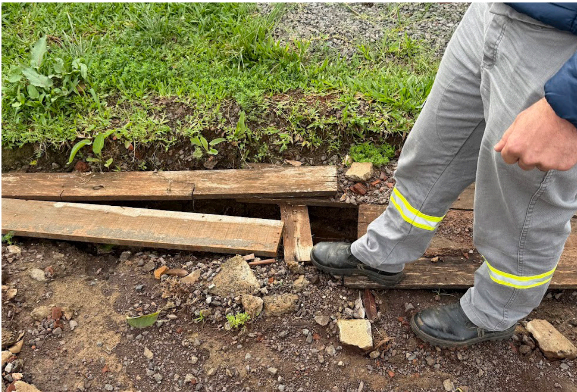
Bueiros quebrados incomodam a comunidade. Infraestrutura urbana é desafio no Nações
