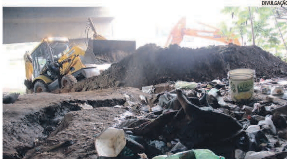
Casa improvisada debaixo do viaduto foi desfeita pelo município
