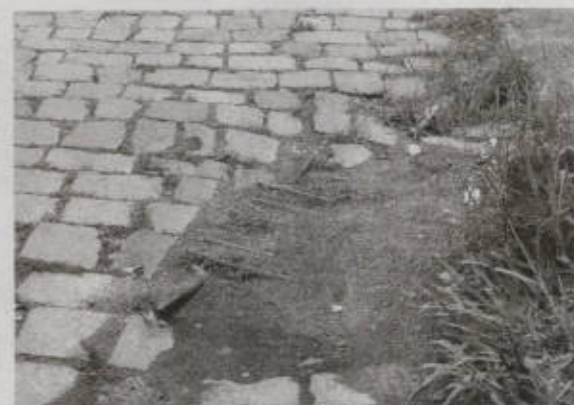
Bocas de lobo entupidas dificultam o escoamento
