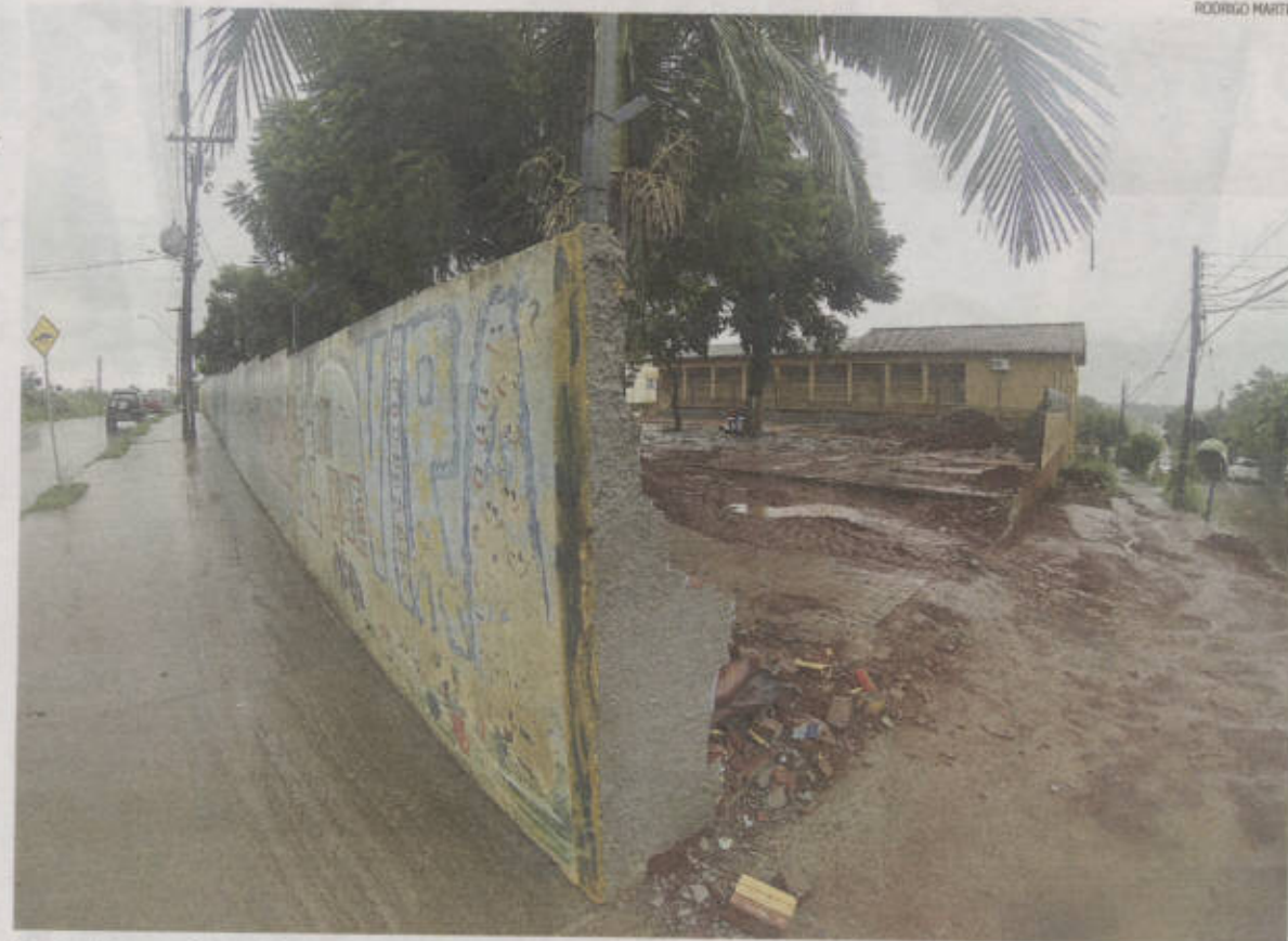
Parte do muro da escola tombou neste mês. Pátio interno segue interditado desde julho do ano passado
