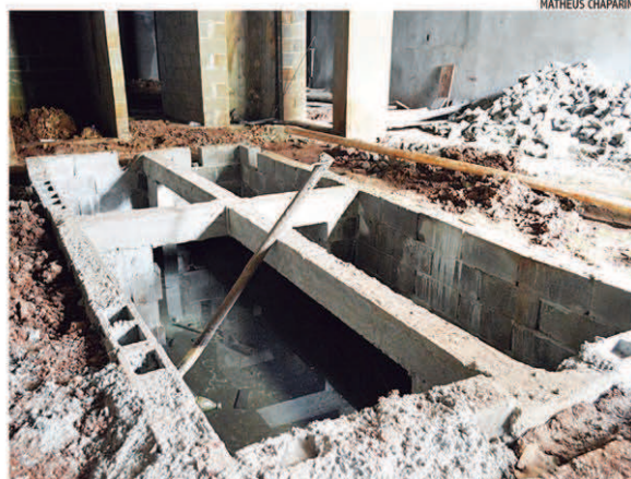
Moradores descobriram água parada em fosso de construção abandonada
