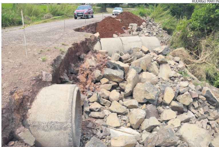
Rua Pedro Ruschel Sobrinho, no Carneiros, segue danificada desde a enchente
