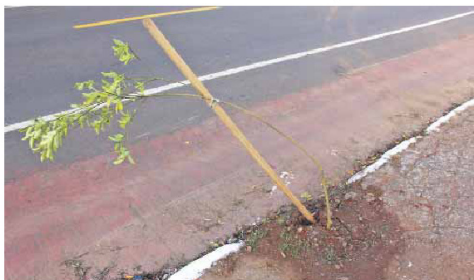
DANOS: plantas e estacas de sustentação foram quebradas
