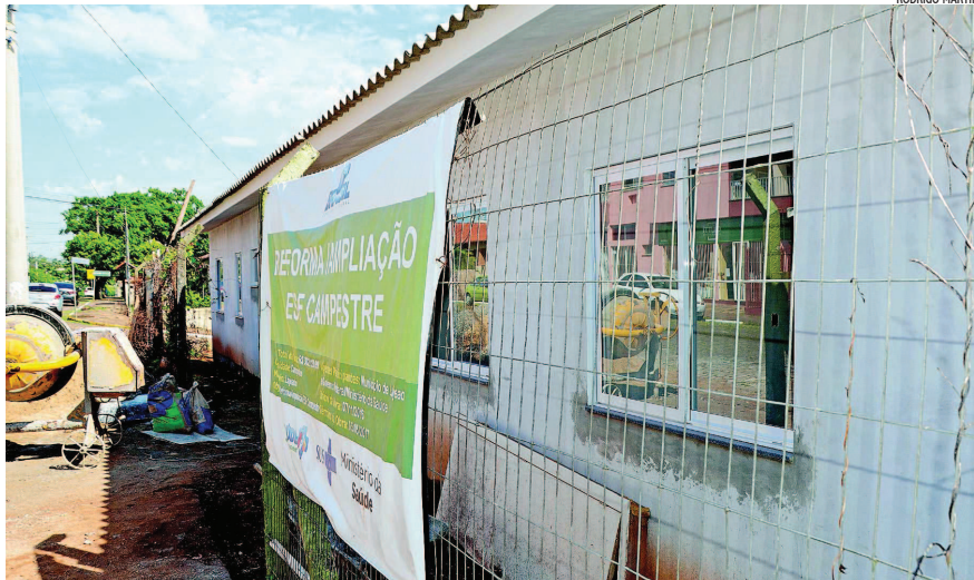
Obra iniciou em novembro de 2016 e foi paralisada diversas vezes. Custo aumentou em mais de R$ 50 mil
