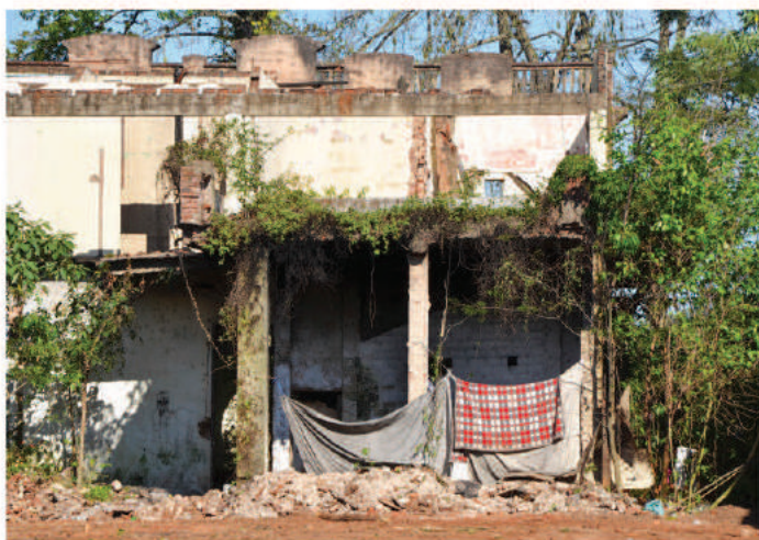
Casa Bruno Born é ocupada por moradores de rua e usuários de droga. Vizinhança teme a queda do prédio.
