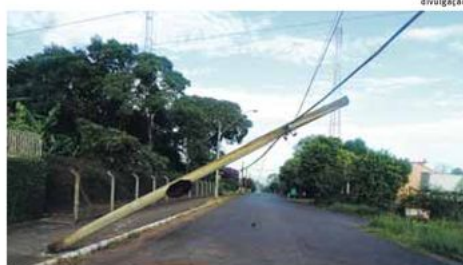
DEGRADANTE: Poste apresenta problemas desde dezembro
